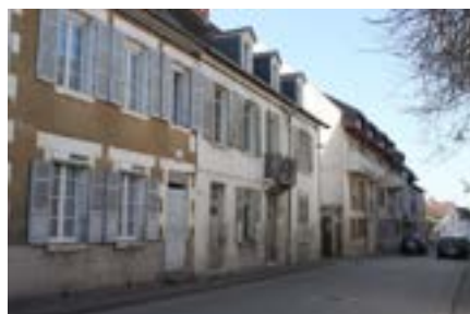
Façade dégradée rue de Verdun
